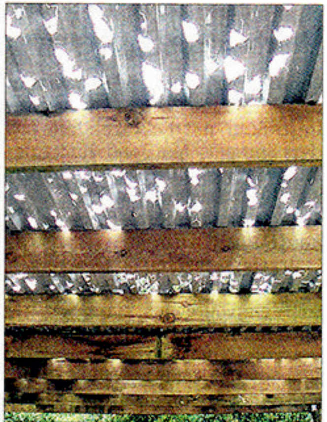
So hinterließen die Hagelkörner ein Carportdach in Riepsdorf. Foto: hfr
